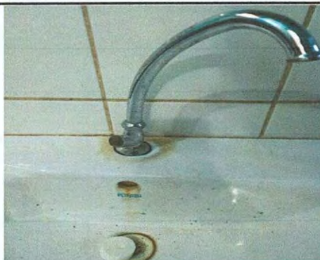
Foto 10: Lavamanos en mal estado y sin función
