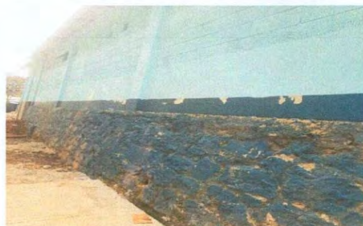
Foto 2: Pintura de establecimiento en mal estado
