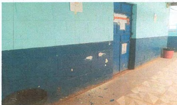
Foto 7: Pintura interior en mal estado
