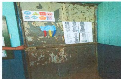
Foto 6: Puertas en deterioradas
