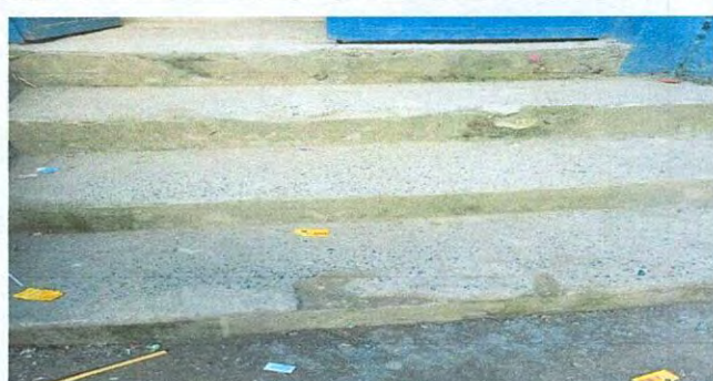
Foto 8: Gradas en mal estado
