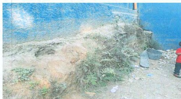
Foto 3: Muro perimetral de escuela en mal estado
