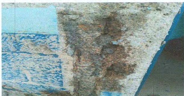
Foto 11: Muro en mal estado
