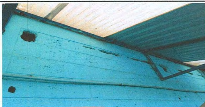
Foto 5: Techo en mal estado
