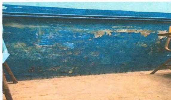
Foto 12: Pintura aula en mal estado.
