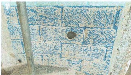
Foto 1: Agujeros en las paredes del establecimiento
